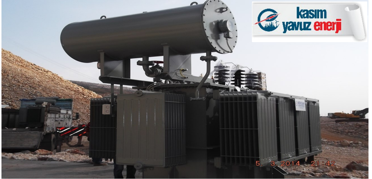
5000 KVA 33/20 KV TBM GÜÇ TRAFOSU
